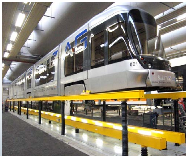
Les installations de levage encastrées dans le sol de Pfaff Verkehrstechnik permettent une maintenance des rames de tramway et des trains à grande vitesse dans les meilleures conditions de confort.
